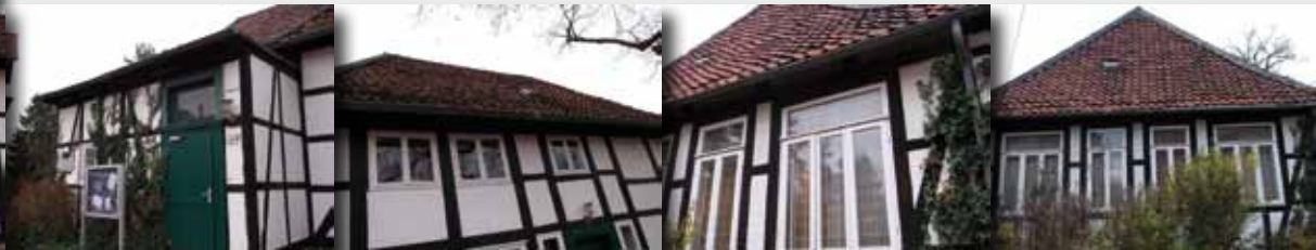
Maroder Zustand eines denkmalgeschützten Gebäudes (Fotos: Thorsten Wendt vom 10.11.2012)
